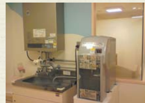
各店のベビー休憩室には火傷防止機能付き給湯器を設置
